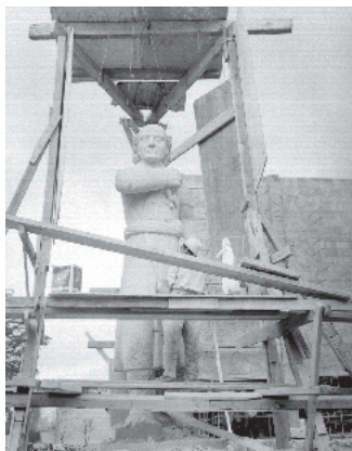
Escultura de Miguel Hidalgo en construcción en la Unidad Independencia, Casasola, XXX Fototeca Nacional del INAH-Sinafo, núm. de inventario 299375.
